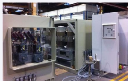
Armoire d'automatisme et contrôle — Moteur
